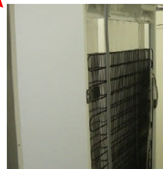
背面の冷媒配管部(コンデンサー) (油漏れ、異常音、外観の確認)
