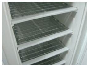
庫内の冷却器・冷媒配管部 (油漏れ、異常音、外観、霜付の確認)
